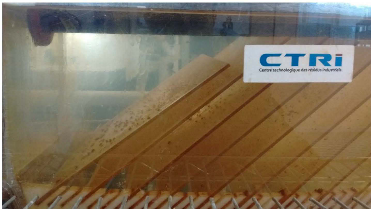
Figure 6.28 : Vue de proche à l'intérieur du décanteur lors de l'essai en continu
