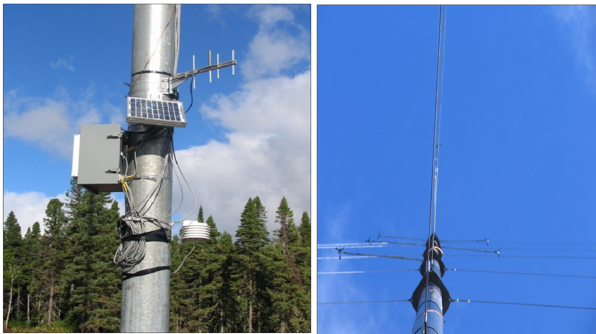
Figure 2.1 Mâts météorologique tubulaire. Source : Hélimax Énergie.
