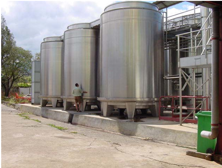
figure 3 : cuves de fermentation
