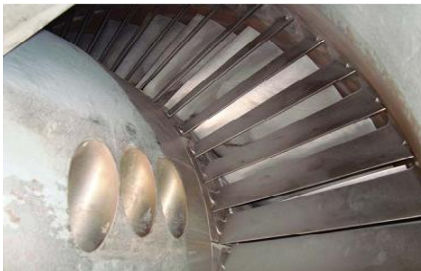
Fig. I.7 Les IGV (Intel Gaz Valve)
