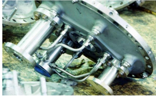
Fig. IV.6 Détecteurs de flamme-Bougies d'allumage DLN1
