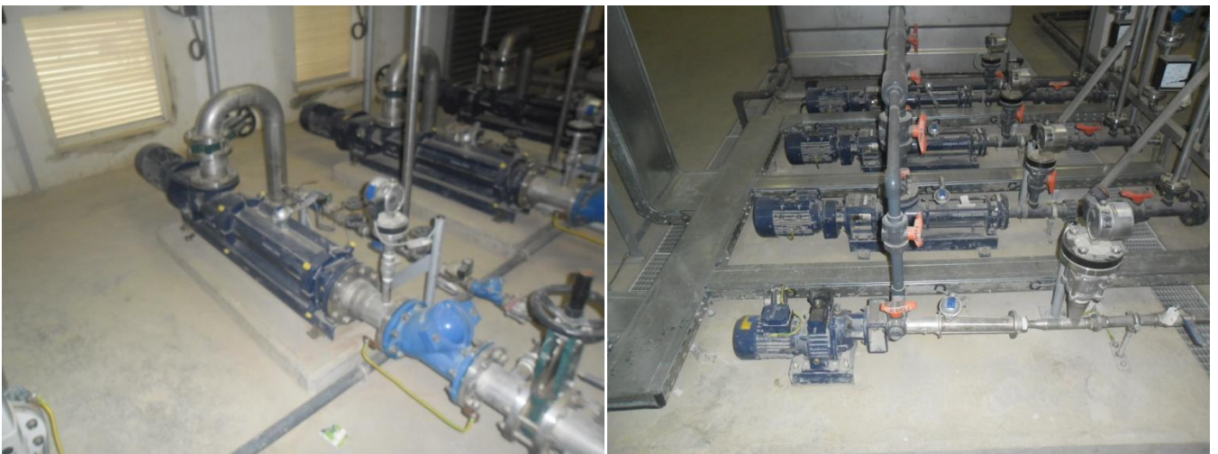
Figure 25 : photo d'une pompe d'injection du polymère et de pompage de boue de la STEP de Fès
