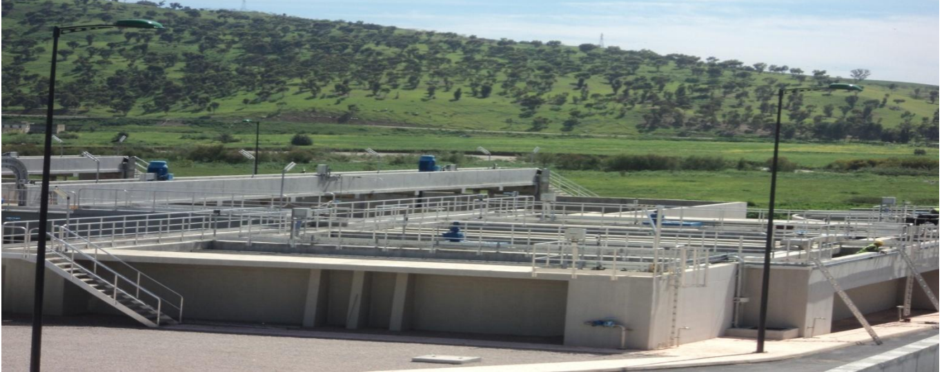
Figure 15 : Photo des décanteurs primaires de la STEP de Fès
