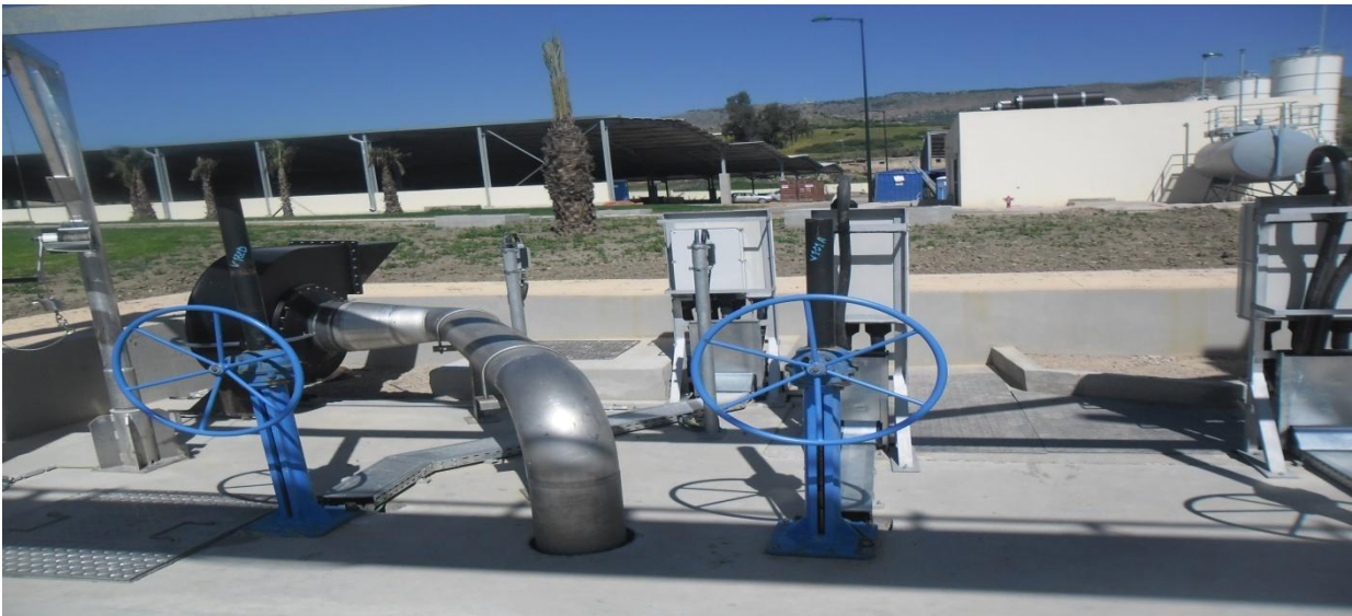
Figure 13 : Photo de la station de relevage de la STEP de Fès
