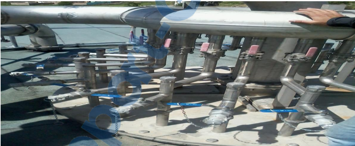
Figure 29 : Photo des conduites de récupération de biogaz de la STEP de Fès
