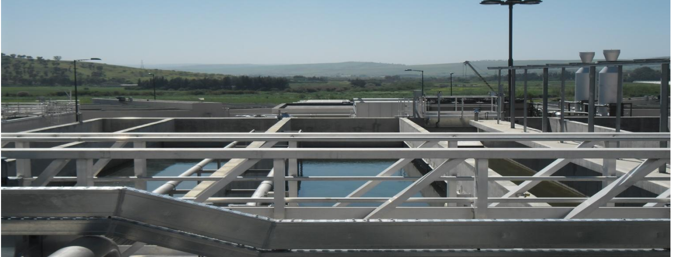
Figure 14 : Photo d'un dessableurs/déshuileur de la STEP de Fès
