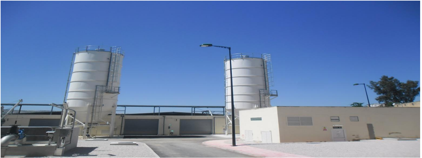
Figure 27 : Photo des silos de la chaux de la STEP de Fès
