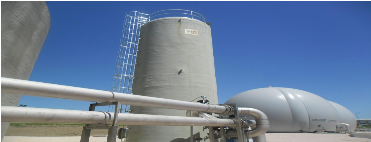
Figure 30 : Photo d'un désulfure de biogaz de la STEP de Fès
