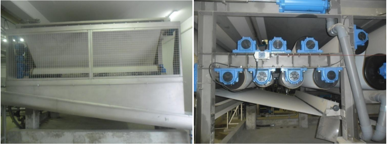
Figure 24 : photo des filtres a bande de la STEP de Fès
