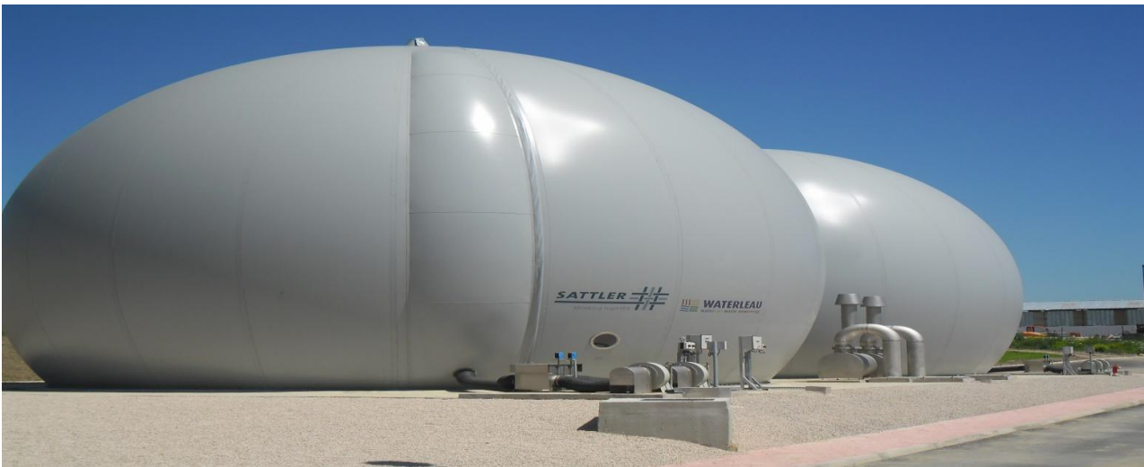
Figure 31 : Photo des gazomètres de la STEP de Fès
