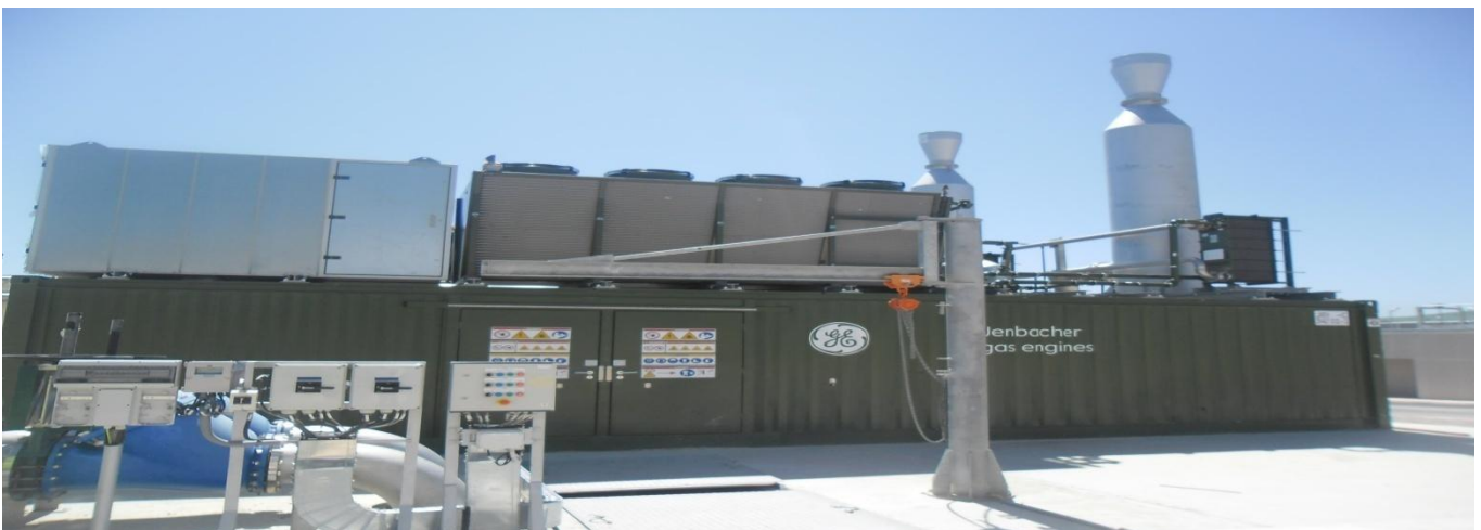
Figure 33 : Photo d'unité de cogénération de la STEP de Fès
