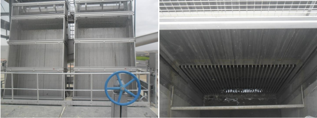
Figure 11 : Photo d'un dégrillage grossier de la STEP de Fès
