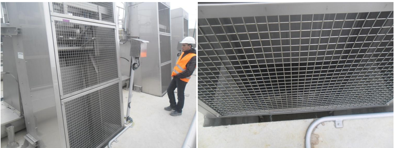
Figure 12 : Photo d'un dégrillage fin de la STEP de Fès
