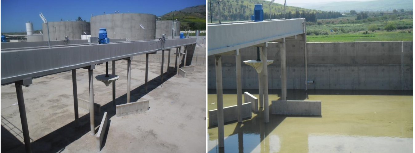
Figure 16 : Photos du bassin d'aération de la STEP de Fès
