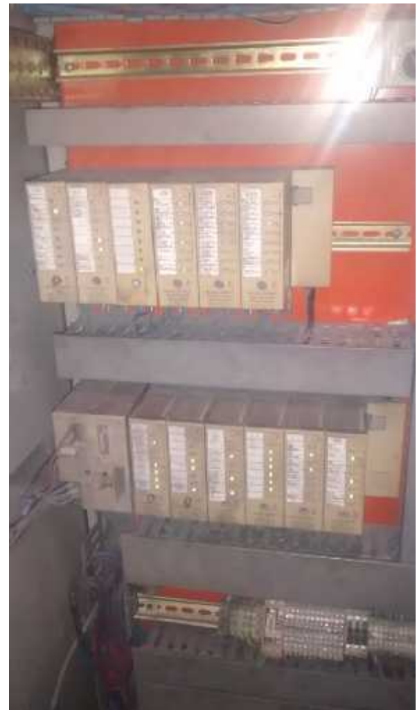
Figure 29 : l'automate SIMATIC S5 avec toutes ses entrées et sorties
