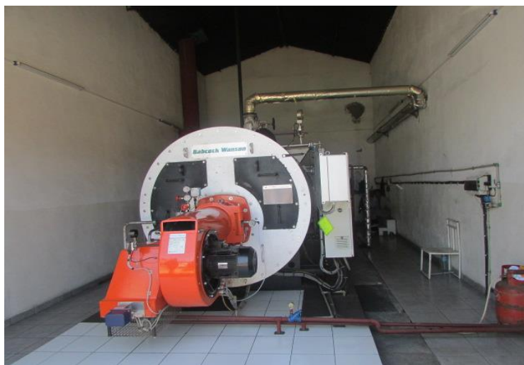
Photo 5: Nouvelle chaudière à fioul
