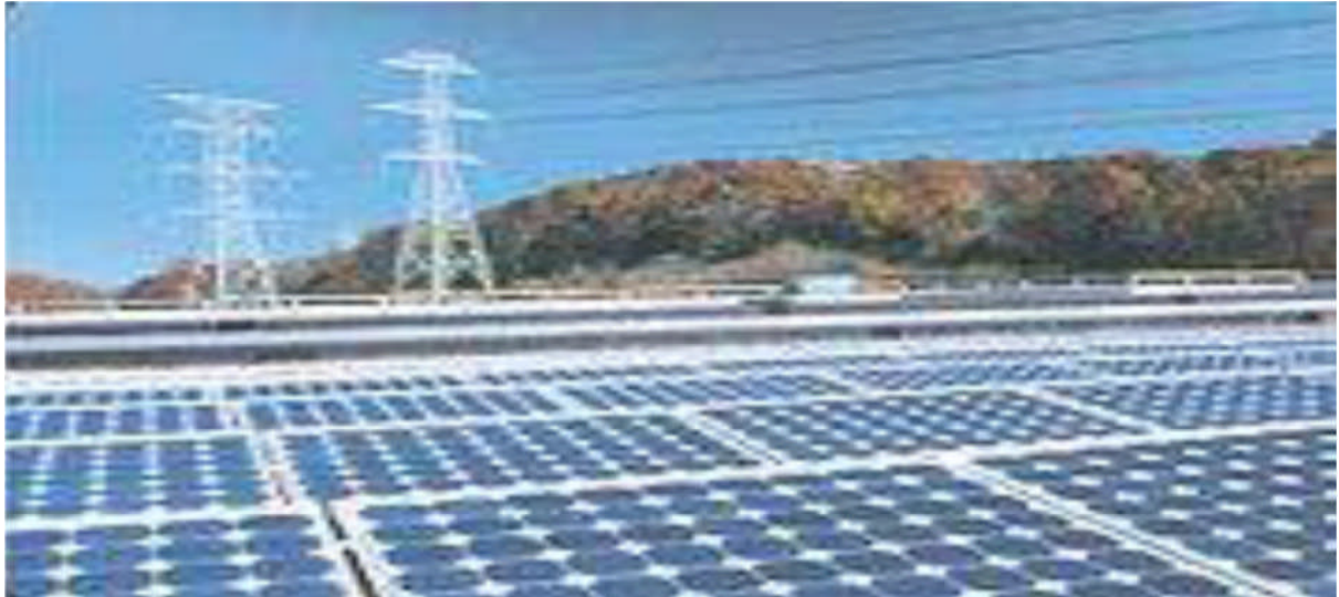
Figure I.8: Champ de panneaux photovoltaïques (capteurs), composés de cellule
