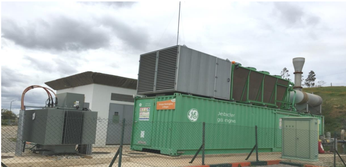
Figure 17: Générateur électrique et transformateur de la centrale
