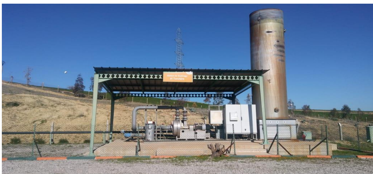
Figure 15 : Unité de soutirage de la décharge et la torchère
