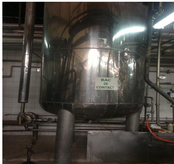
Figure 11 : Bac de contact
