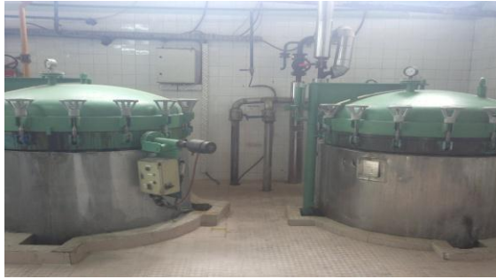
Figure 16 : Filtres à plaques
