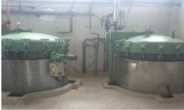
Figure 15 : Filtres à plaques
