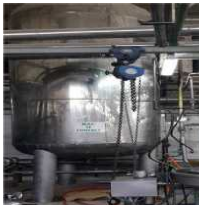
Figure 10 : Bac de contact :
