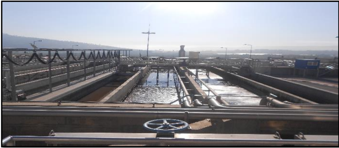
Figure 1.3 : Photo d'un dessaleurs/déshuileur
