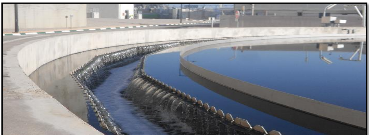
Figure 1.6 : Photos d'un clarificateur
