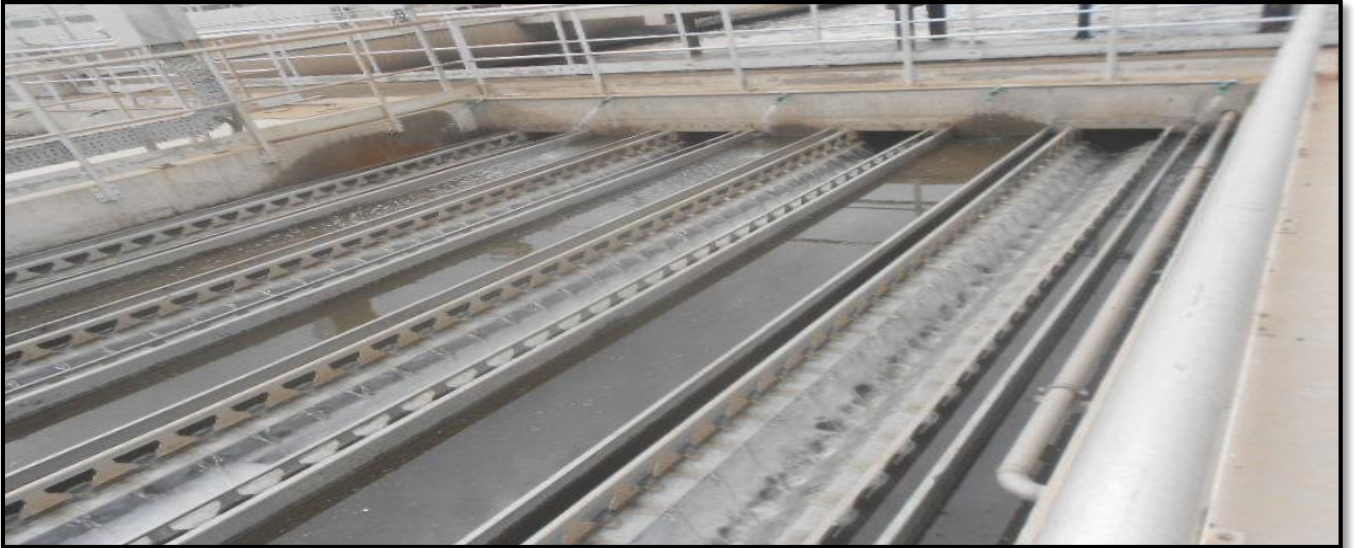
Figure 1.4 : bassin de décantation primaire (système laminaire) STEP Fès
