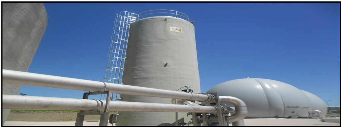
Figure 1.11 : Photo d'un désulfure de biogaz
