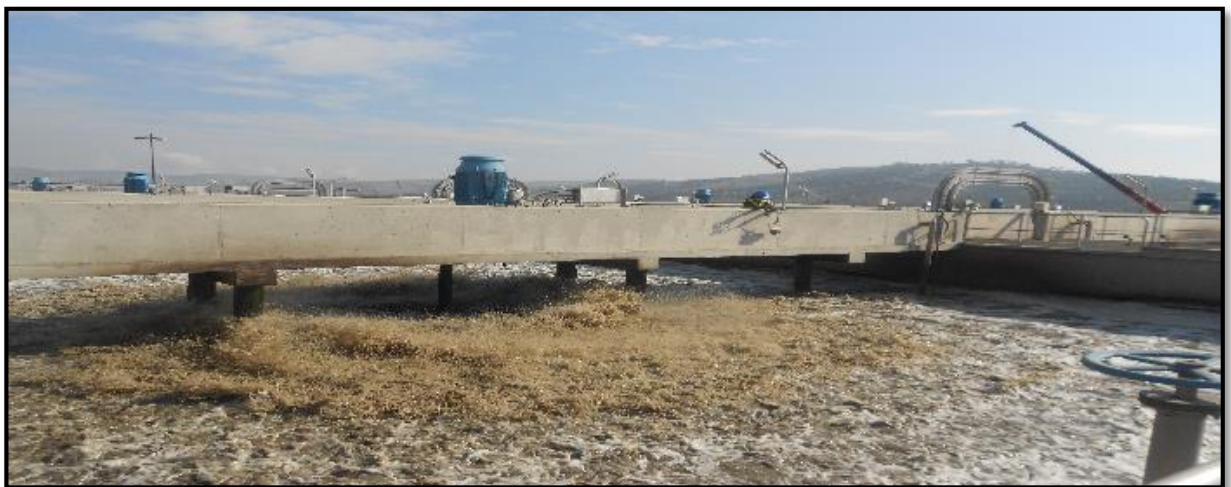
Figure 1.5 : Photos du bassin d'aération
