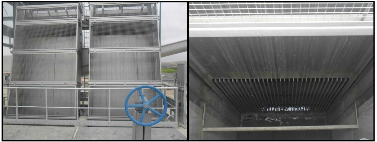
Figure 1.1 : Photo d'un dégrillage grossier
