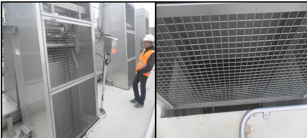
Figure 1.2 : Photo d'un dégrillage fin
