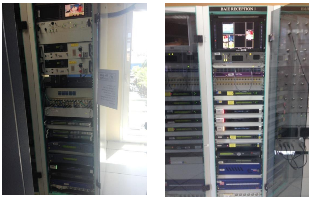
Figure 4 : Baie d'émission (à gauche) et baie de réception (à droite) 2M National
