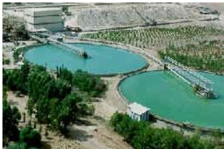
Figure 6: Décanteur D1 et D2.
