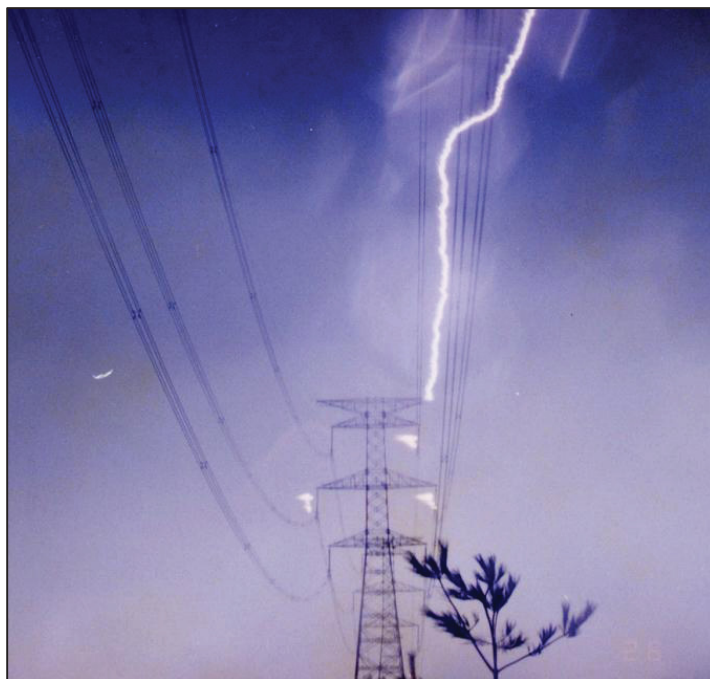
Figure 0-2 Amorçages en retour par un éclair d'hiver sur une tour de transmission à double circuit de 500 kV Tirée de Hokuriku Electric Power Co. (1995)
