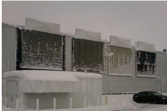
Figure 3.12 Photographie des collecteurs, le 11 décembre 2014
