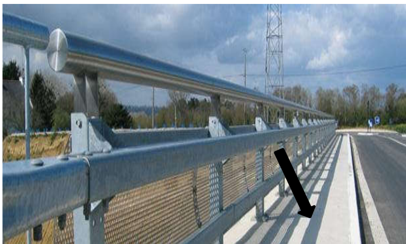
Photo 4.19 : les dispositifs de protection
