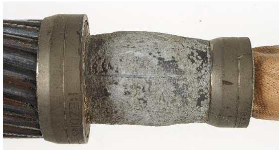
Photo 91 : Produits de corrosion recouvrant de larges surfaces
