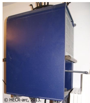
Photo. 1 : Déshumidificateur défectueux de la zone Hall.
