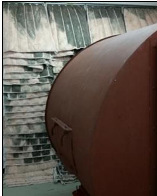
Figure-A-I-2 Filtre protecteurs à l'intérieur de salle mécanique
