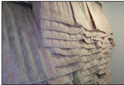
Figure 5. 9 Filtres de la salle mécanique
