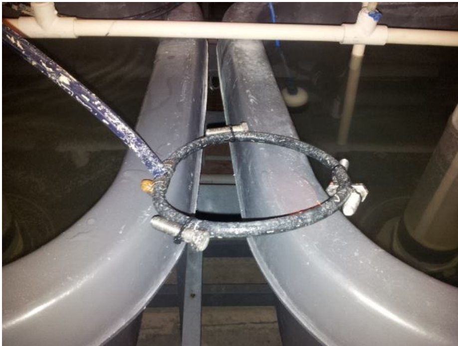
Figure 38 : Tuyau circulaire à micropores fins. Ces tuyaux étaient disposés autour des crépines, au fond des bassins et étaient alimentés par de l'air comprimé (30psi)
