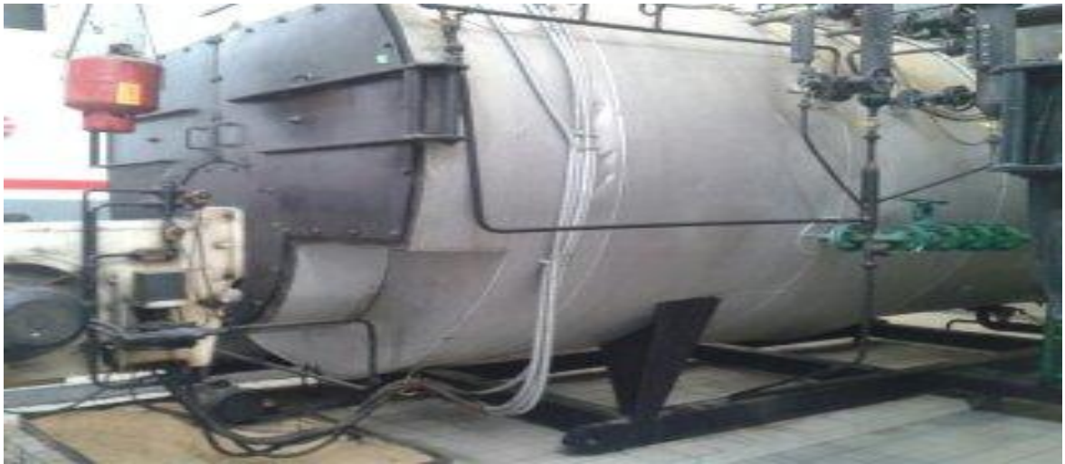
Figure 6 : Image de la chaudière à Fuel
