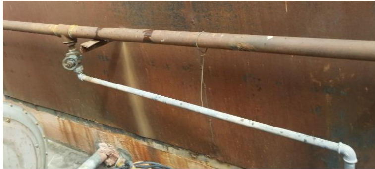
Figure 14 : Conduite de propane
