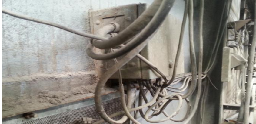
Figure 18 : boîtier électrique du ventilateur d'air
