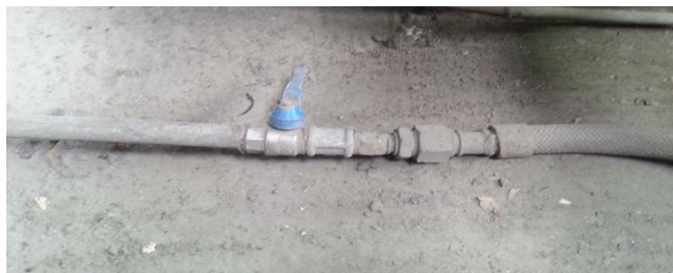
Figure 17 : Conduite équipée de vanne manuelle
