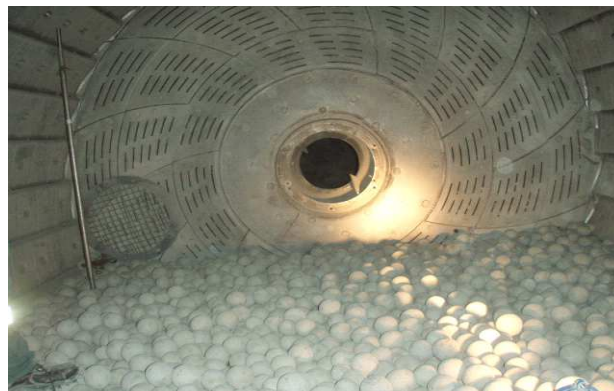
Vue de l'intérieur du BK3 : broyeur à boulets
