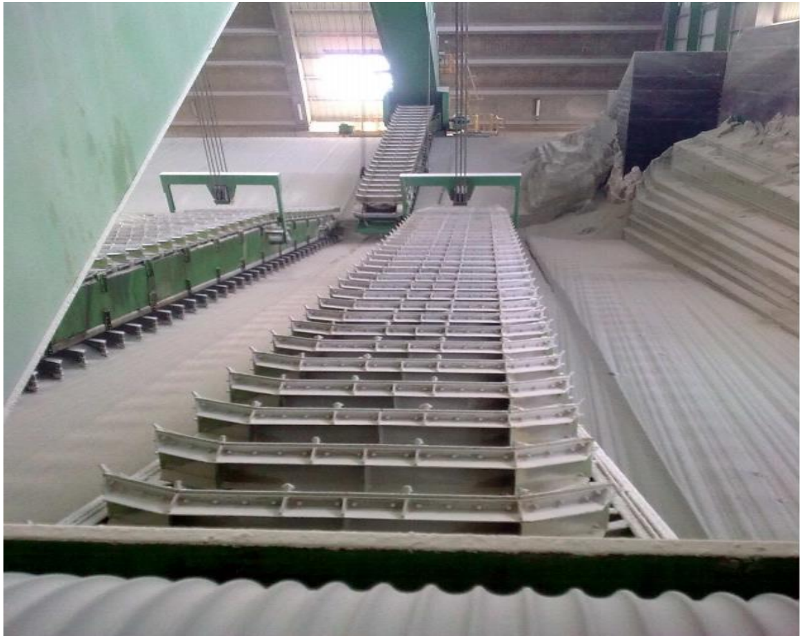
Figure II.7 : Vue sur les bras de grateur
