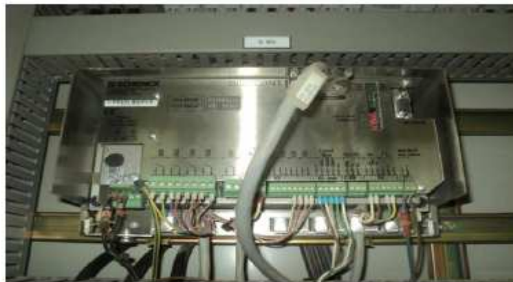
Figure 3-9 : Unité d'entrée/sortie VEA
