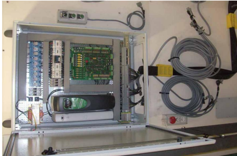
Figure 1.8 : Armoire de manœuvre
