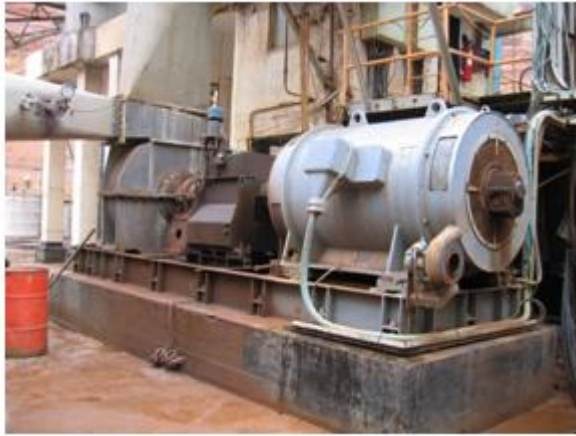
Ancien ventilateur K102
