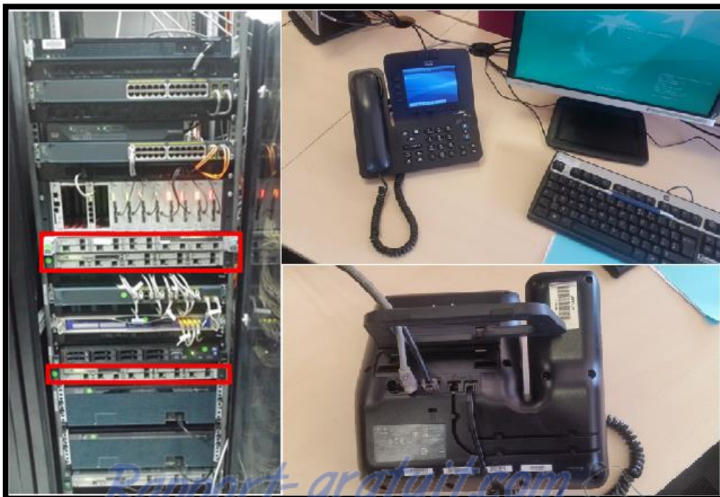
Figure 29 : La mise en place du cluster Call Manager et les téléphones IP.
