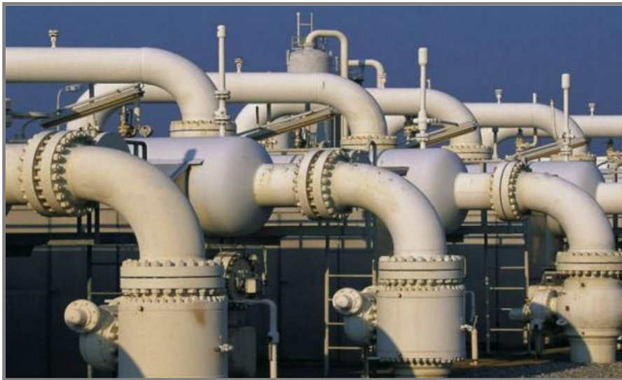
Fig. 1. 1 Canalisations dans une installation pétrolière
