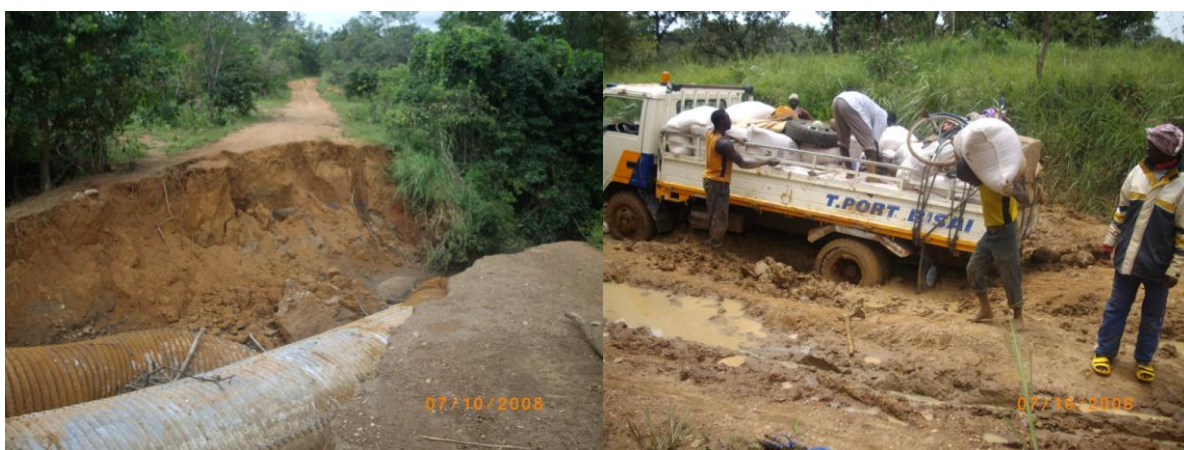
Photo 13 : Effondrement du pont de Wouldé et transbordement d'un chargement de vivres
