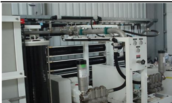
Figure III.6 : Osmoseur.SSH62-928 équipé d'un turbo
