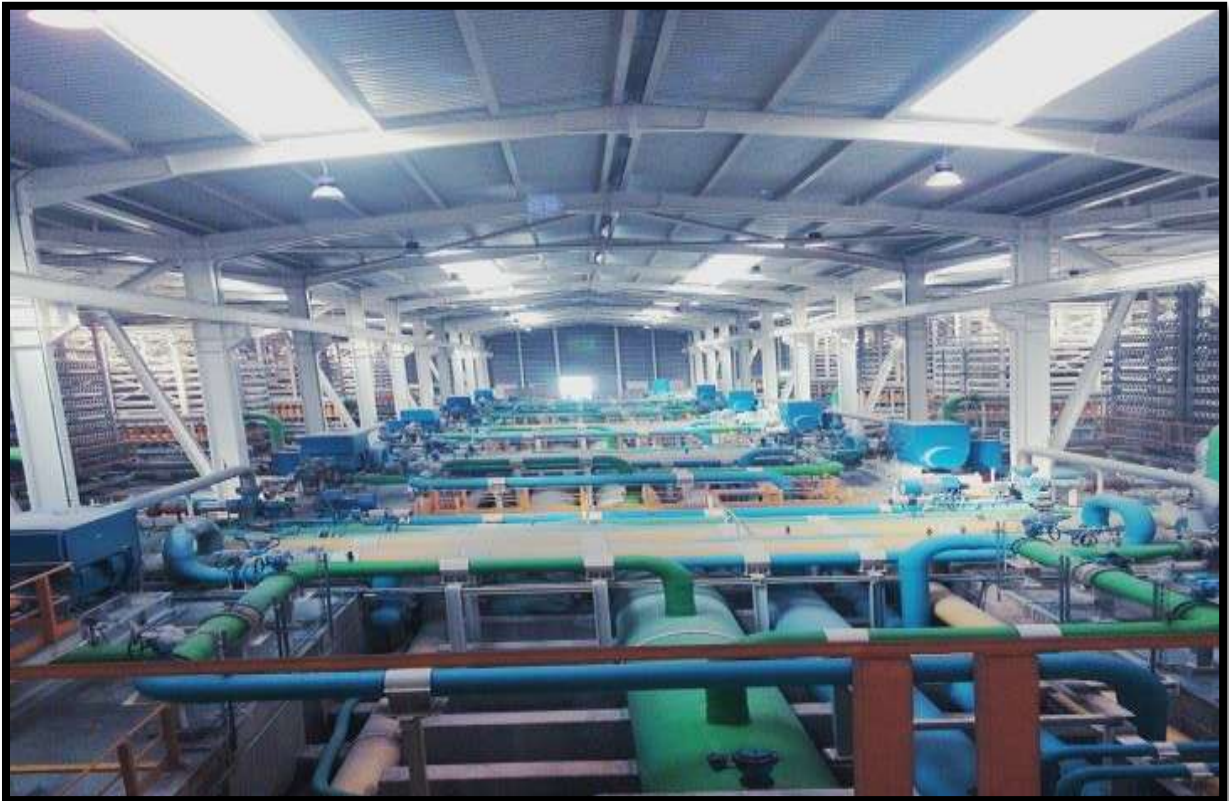
Figure II.11 : Station de dessalement de Honaine
