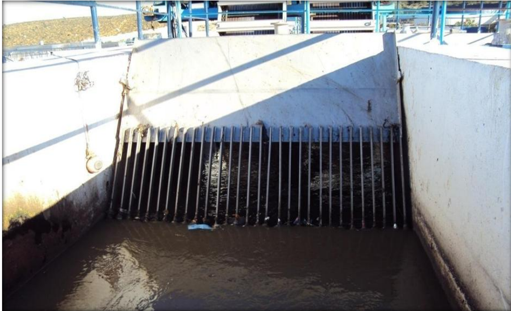
Figure III.4 : Photo d'une grille grossière manuelle [31]
