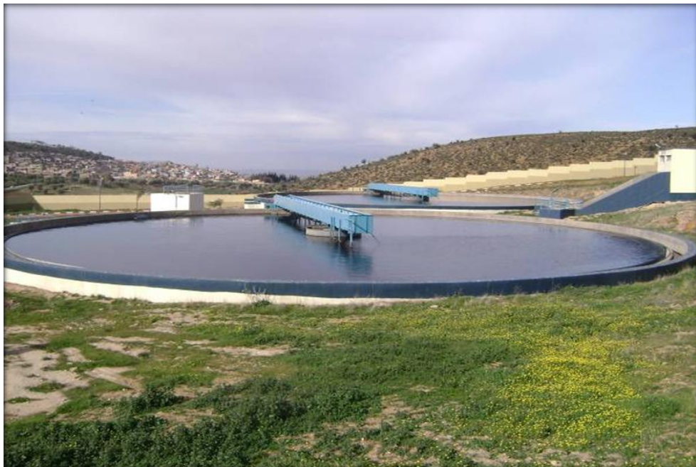
Figure III.9 : Photo du clarificateur
