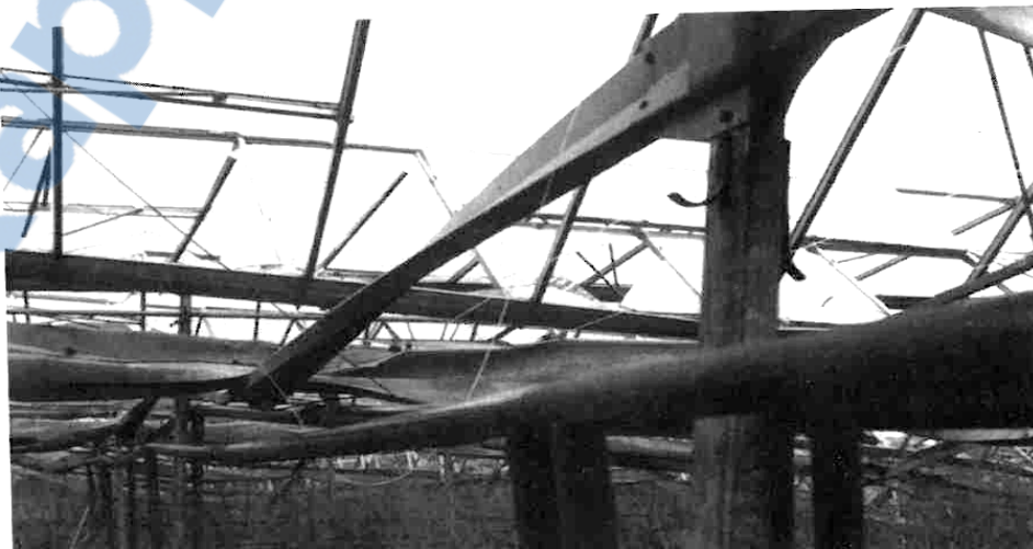
Photo I.2 : Effondrement à cause du déversement d'une poutre
