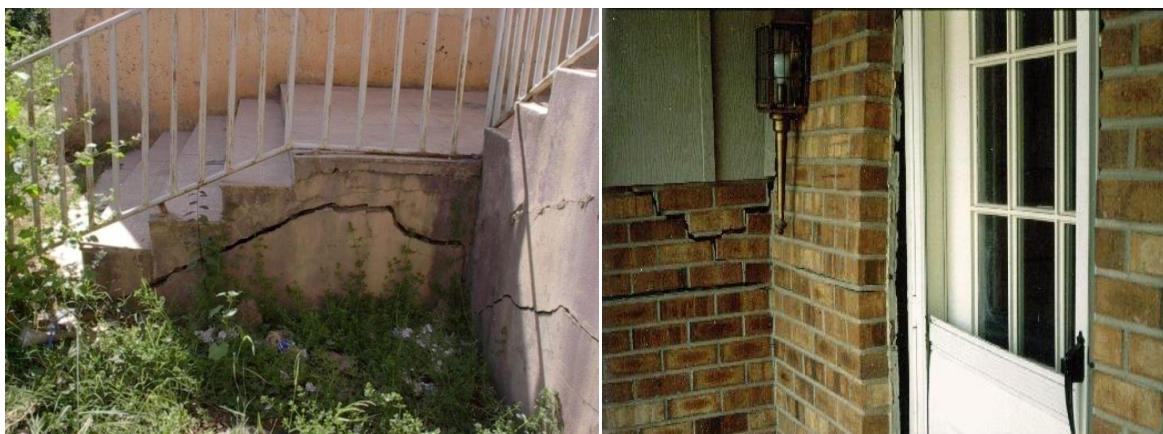
Figure 1.16. Les fissurations causés par le gonflant.
