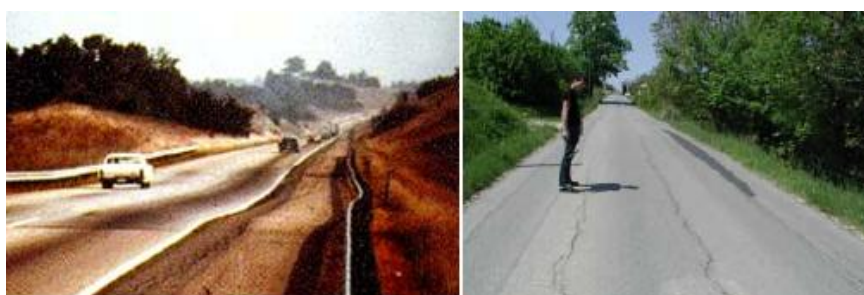
Figure 1.17. Le gonflement affecte la route.
