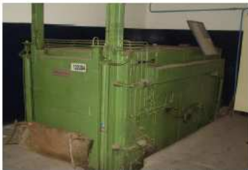
Figure 10 : Four de stabilisation
