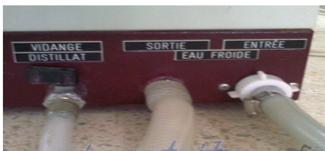
Figure III.5 : Vidange et sortie d'eau de refroidissement
