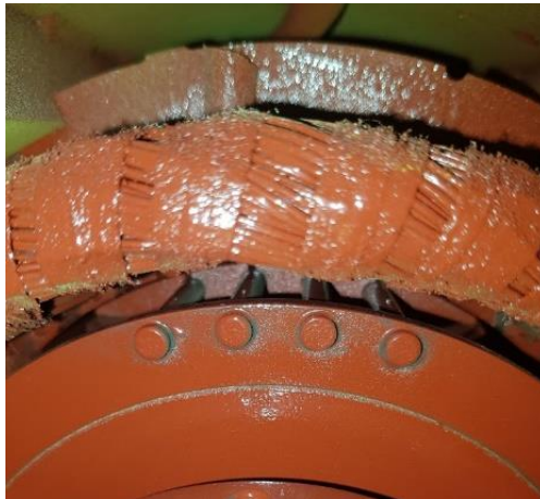
Figure 12 Image de l'intérieur de la génératrice avec la cage d'amortissements
