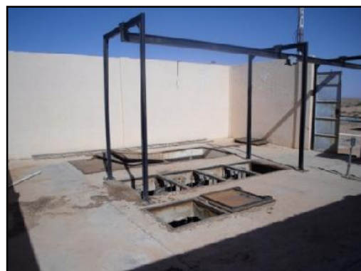
Figure I.4 : station de relevage Hay Ezzouhour vue intérieur (20/05/2012)
