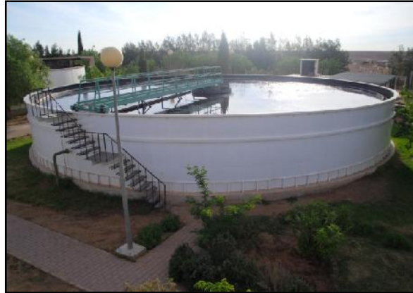
Figure III.10 : Le bassin de clarification (22/05/2012)
