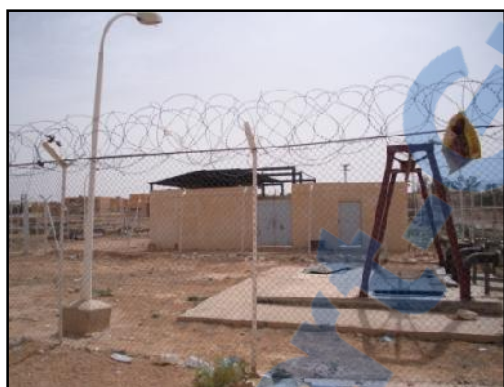
Figure I.7 : Station de relevage F3 (OPGI) vue extérieur (20/05/2012)
