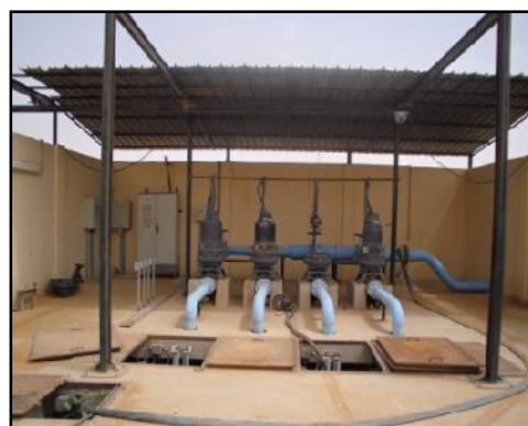
Figure I.8: Station de relevage F3 (OPGI) vue intérieur (20/05/2012)
