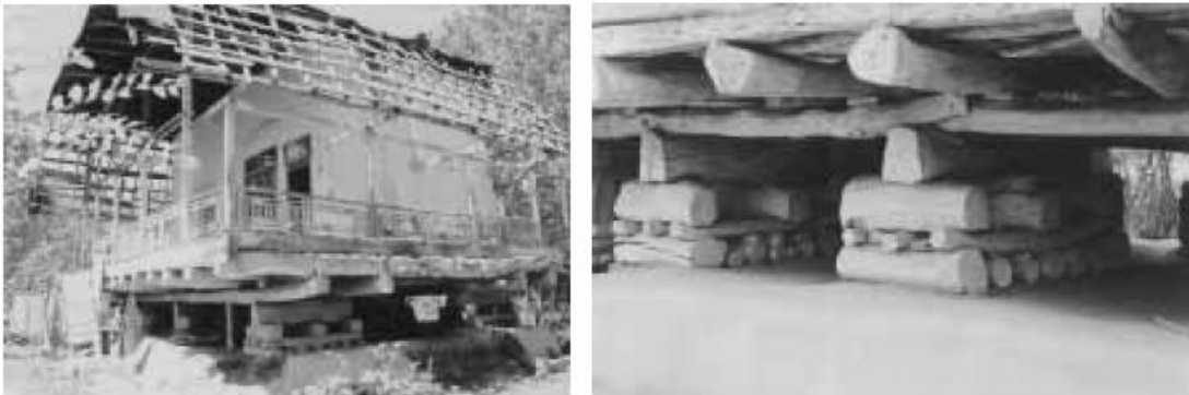
Figure I.1 : Morceaux de bois installés entre la base et le palier des maisons en Iran.
