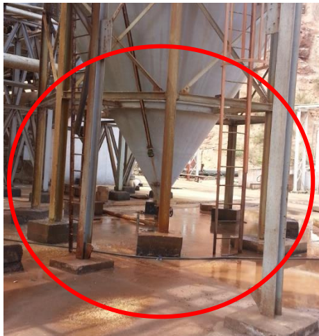
Figure II. 25 : Disparition du contreventement
