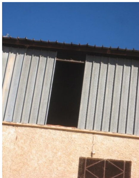
Figure II. 29 : Disparition du bardage latéral
