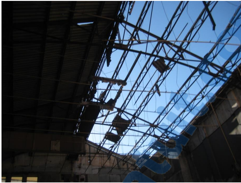
Figure II. 39 : Disparition de la toiture
