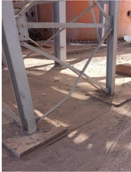
Figure II. 24 : Déformation du contreventement
