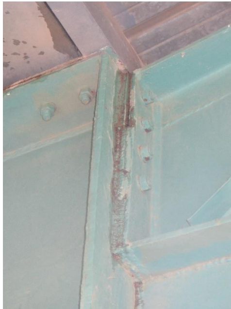
Figure II. 7: Ecoulement d'eau sur l'assemblage
