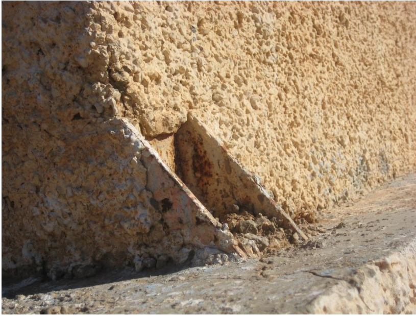
Figure II. 32 : Corrosion du raidisseur de poteau
