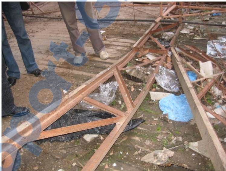
Figure II. 40 : Chute de la panne métallique
