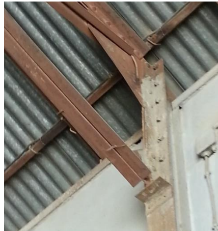
Figure II. 52 : Corrosion des éléments métalliques
