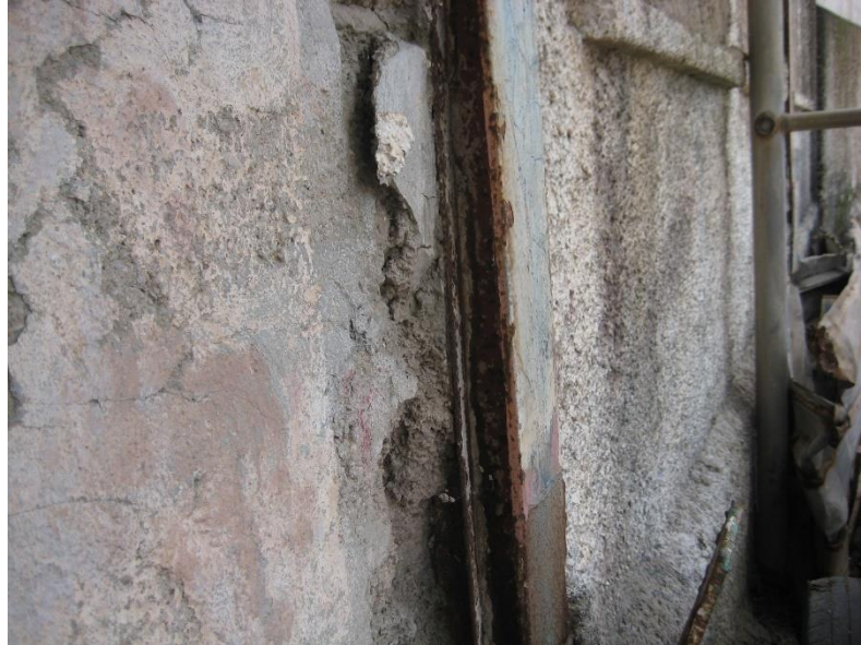
Figure II. 16 : Corrosion de poteaux métallique
