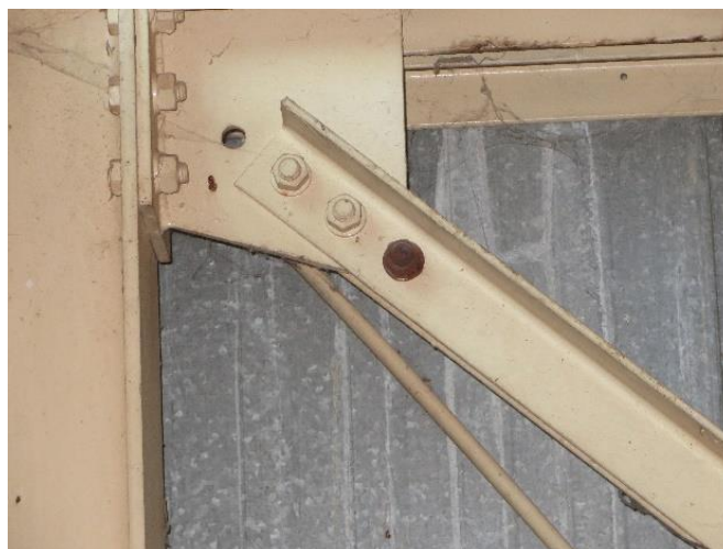
Figure II. 58 : Mauvaise conception de gousset pour contreventement.
