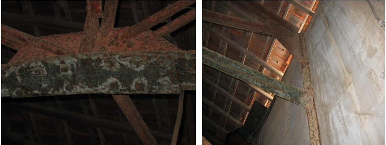
Figure II. 18: Eléments inférieurs de la poutre en corrosion
