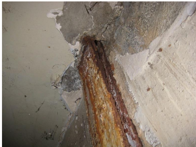
Figure II. 19: Corrosion du poteau d'intérieur.
