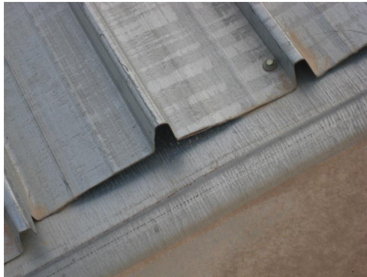
Figure II. 45 : Mauvaise fixation de couverture
