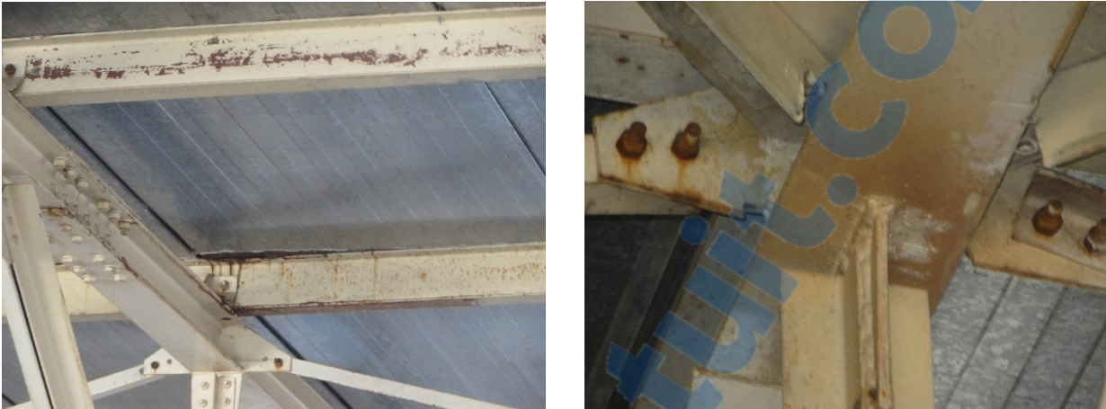
Figure II. 56 : Mauvaise étanchéité de la toiture
