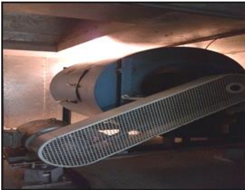
Figure 08 : Ventilateur de retour (Benhadj.A ; 2014)
