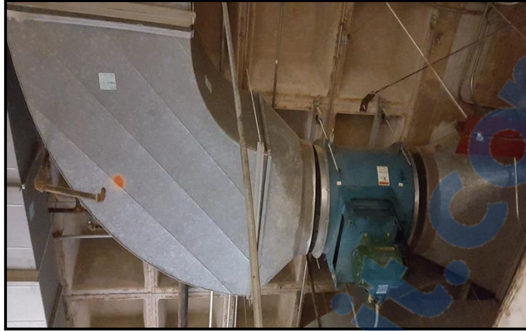
Figure 09 : Ventilateur d'évacuation (Benhadj.A ; 2014)
