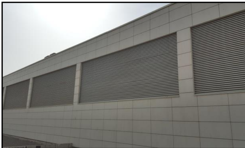
Figure 02 : Persienne de prise d'air extérieur (Benhadj.A ; 2014)
