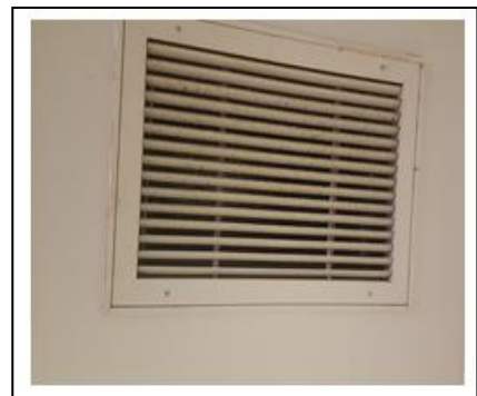
Figure 32 : Grille de reprise d'air
