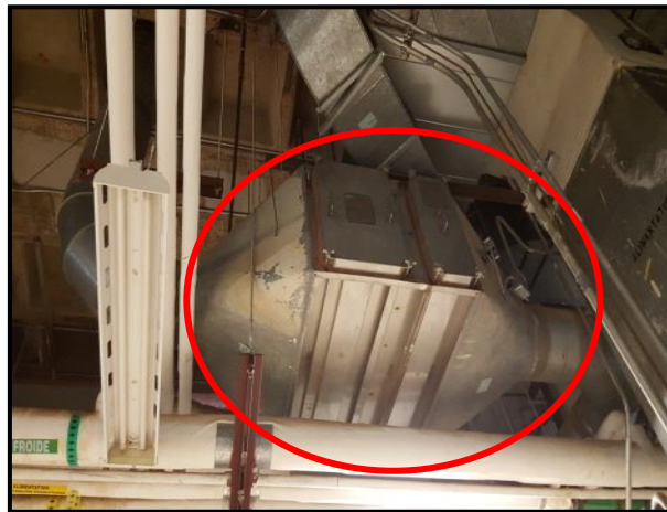
Figure 35 : Caisson de filtration
