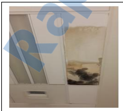
Figure 30 : Tache de moisissures (faux plafonds)
