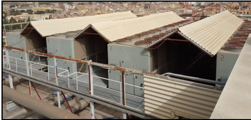
Figure 12 : Tours aéro-réfrigérantes (Benhadj.A ; 2014)
