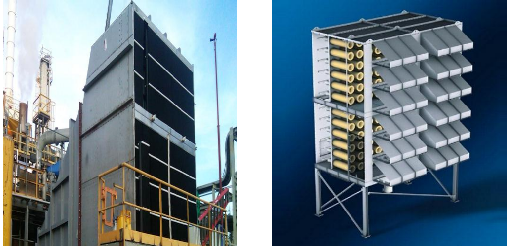
Figure (IV.3) : filtre d'air de la Turbine MS5002C
