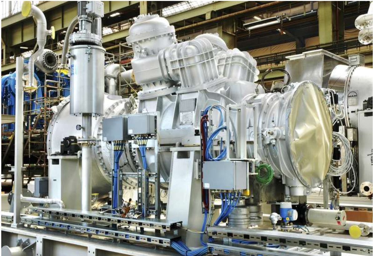
Figure (II.28) : Turbines à gaz MAN THM 1304
