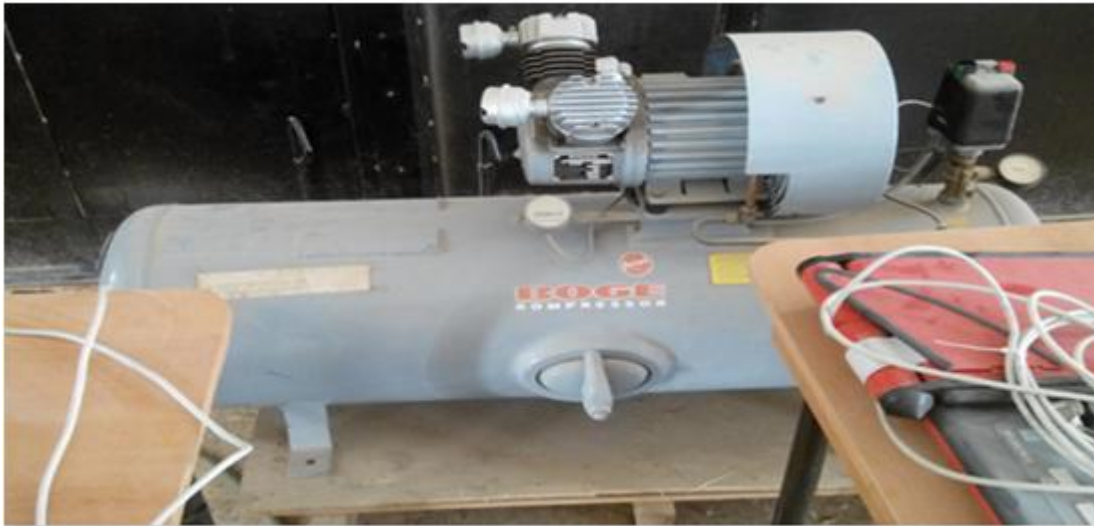
Figure I.14b compresseurs BOGE SBD 250 litres
