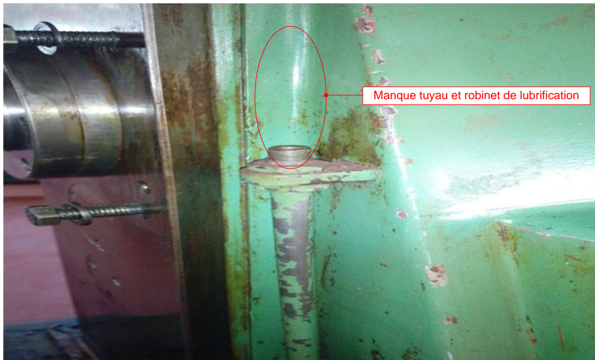
Figure III.5 manque du tuyau et robinet de lubrification.
