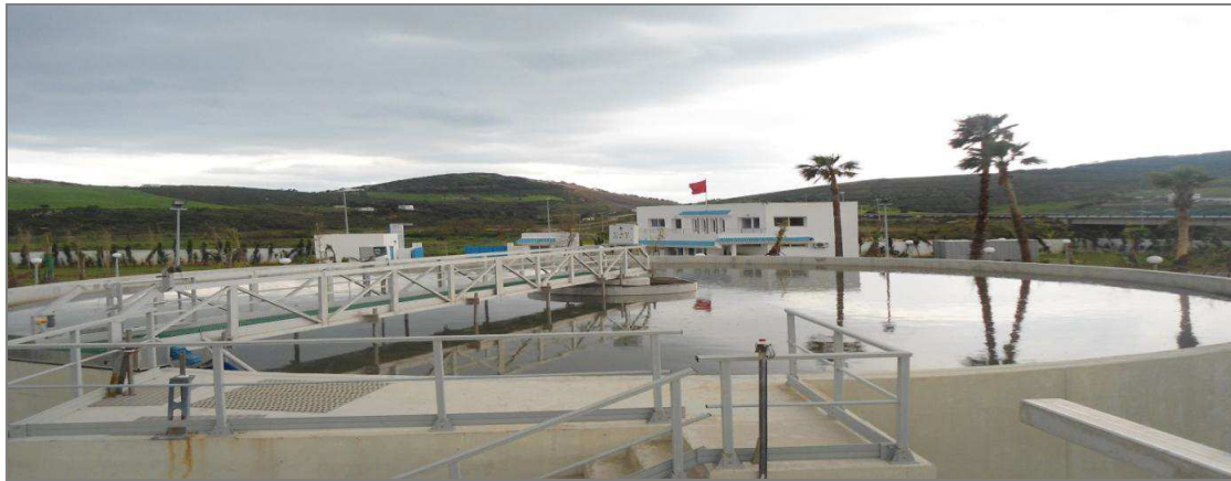
Photo 3 : Le décanteur primaire
