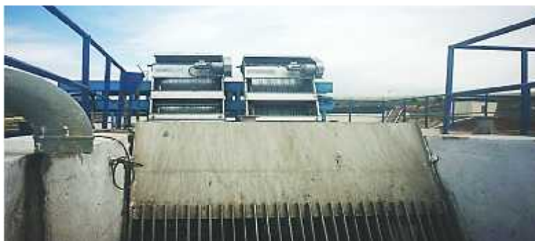
Figure III.4 : Grille grossière manuelle (1unité)
