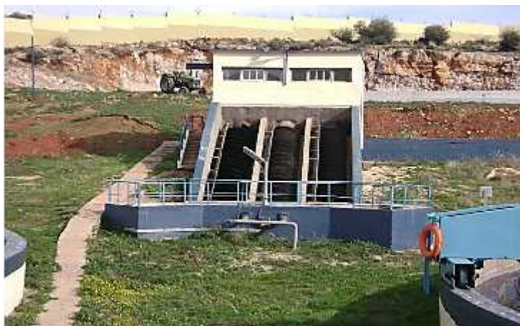
Figure III.11 : Vis relevage des boues
