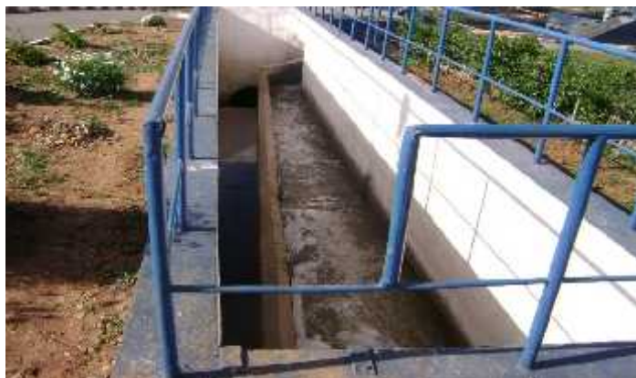
Figure.III .3: Photo Déversoir d'orage
