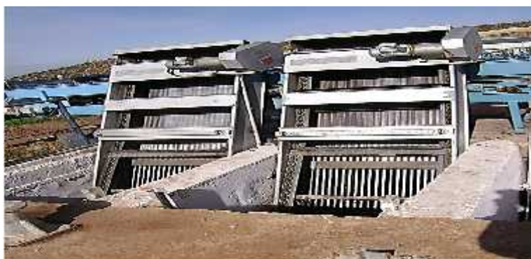
Figure III.5 : Grille mécanisée (2 unités)
