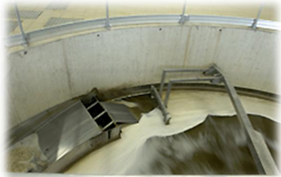
Figure II.4 Evacuation des huiles et graisses dans un dégraisseur déshuilage circulaire [33].
