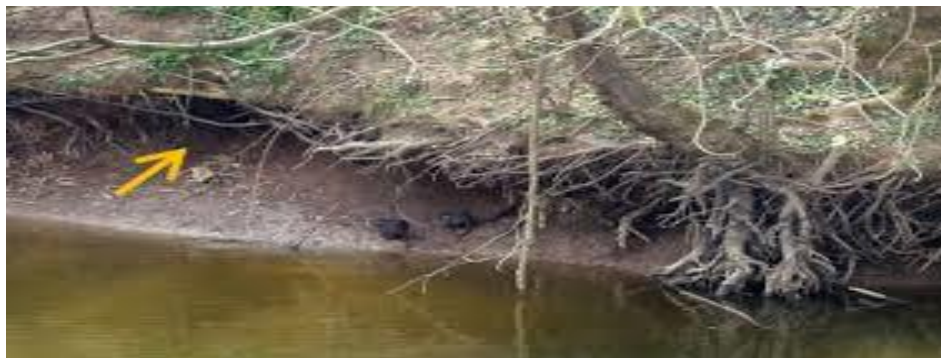
Photo I.1 : Erosion des berges [1]
